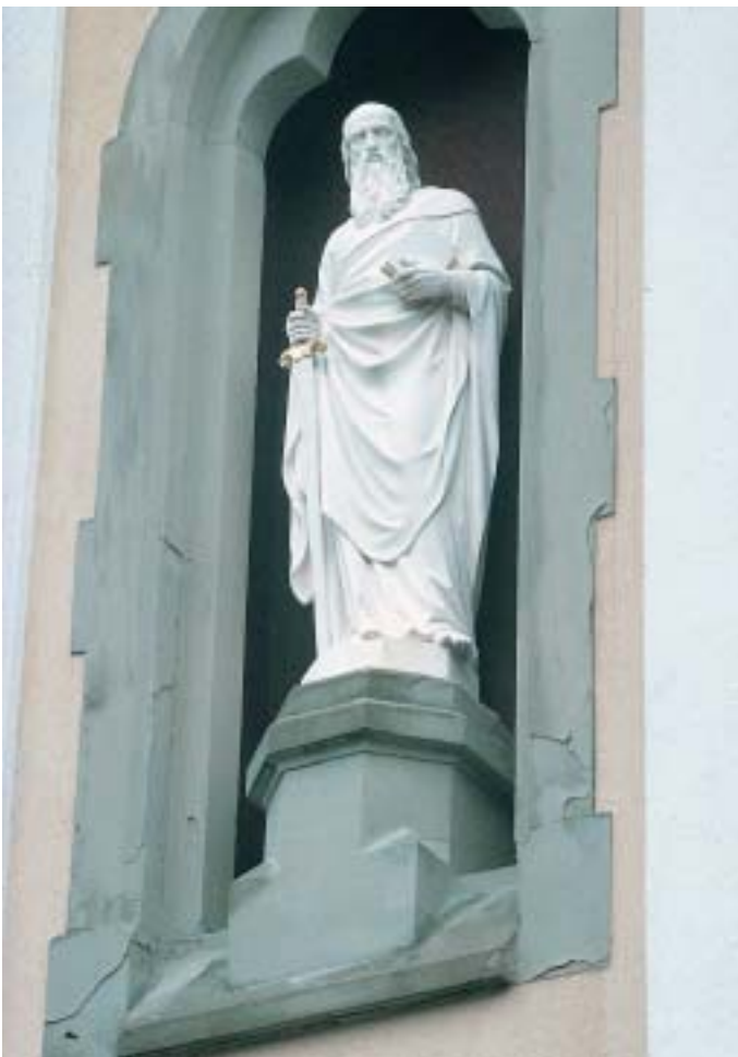
Hydrophobiertes Sandsteingewände, das nach wenigen Jahren Schalenbildungen von sechs bis acht Millimetern ausweist
