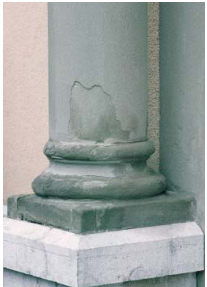
Klassischer Hydrophobierungsschaden: Kapillarwasser hat die Hydrophobierung hinterwandert und zu Frostsprengungen geführt
