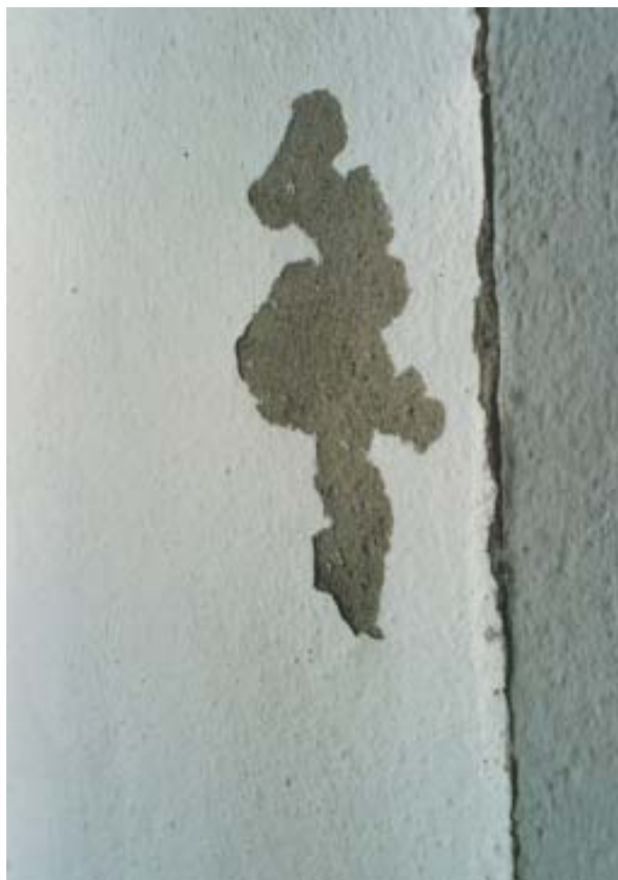
Über Anschlussrisse zwischen Gewände und Verputz eingedrungenes Wasser hinterliegt der Hydrophobierung
