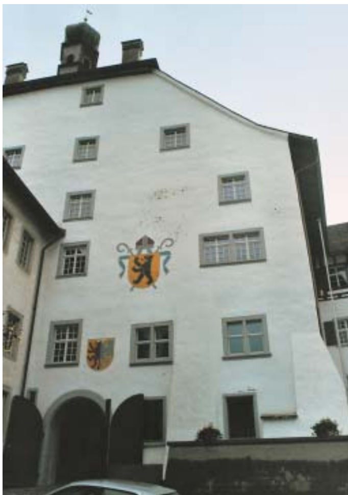
Auf einen neu aufgetragenen Kalkputz wurde eine hydrophobierte Kalkfarbe aufgetragen. Folge: Die Karbonatisierung hat sich drastisch verzögert, und das in die hydrophilen Verputze eingedrungene Wasser verursacht Frostschäden
